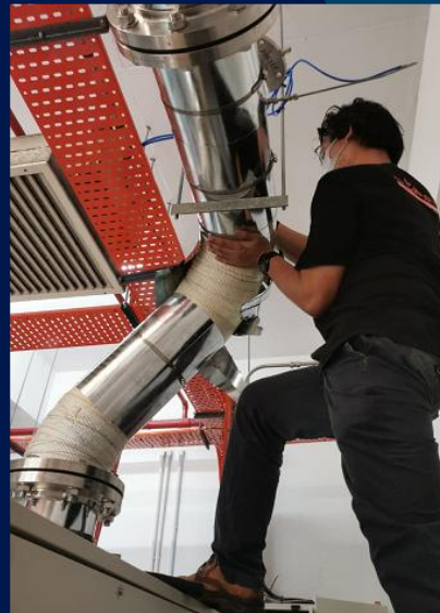
Exzos pipe for mini gas turbine at UNITEN
